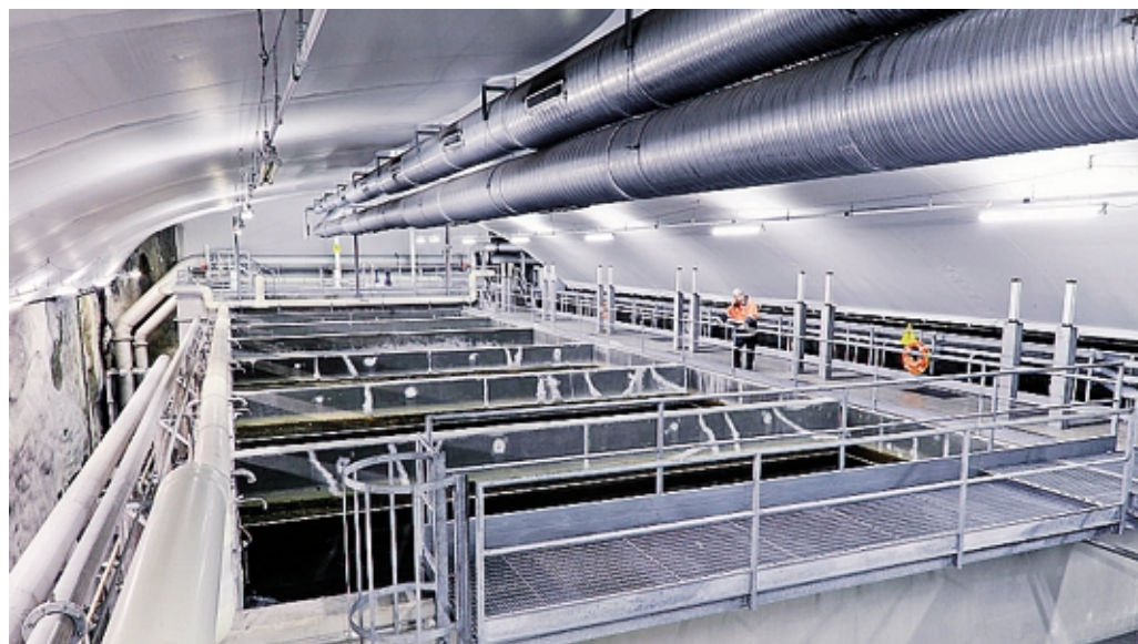
La centrale di potabilizzazione dell'acquedotto di Como
