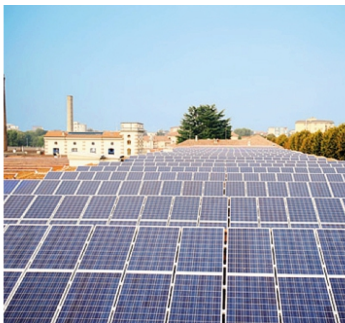
La copertura di un edificio con i pannelli fotovoltaici
