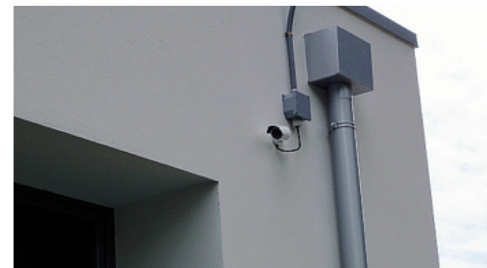
Un impianto di videosorveglianza
