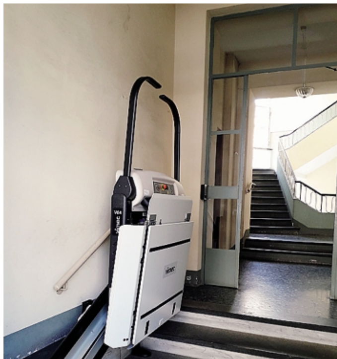
Un montascale all'ingresso di un condominio
