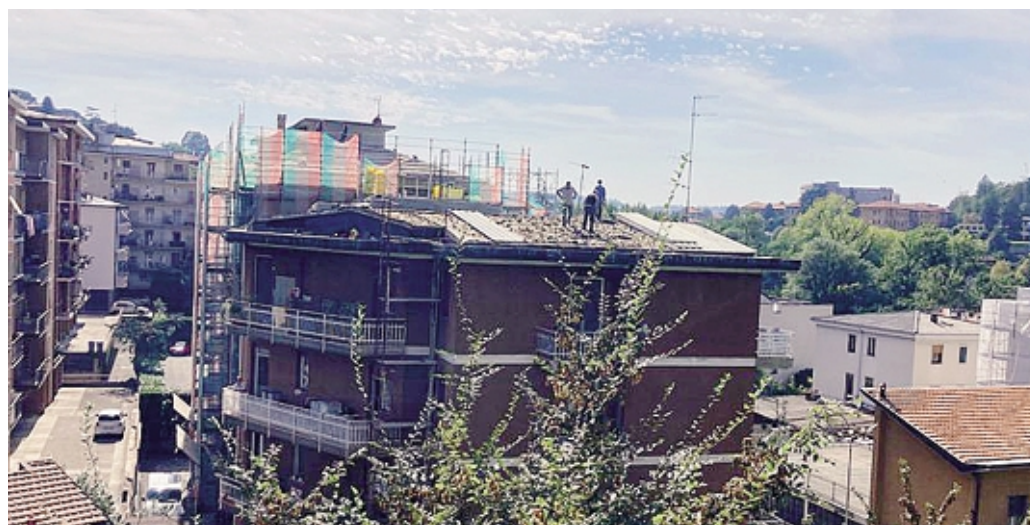
Tre operai in piedi sul tetto di un condominio in zona Como Sole, senza alcuna protezione
