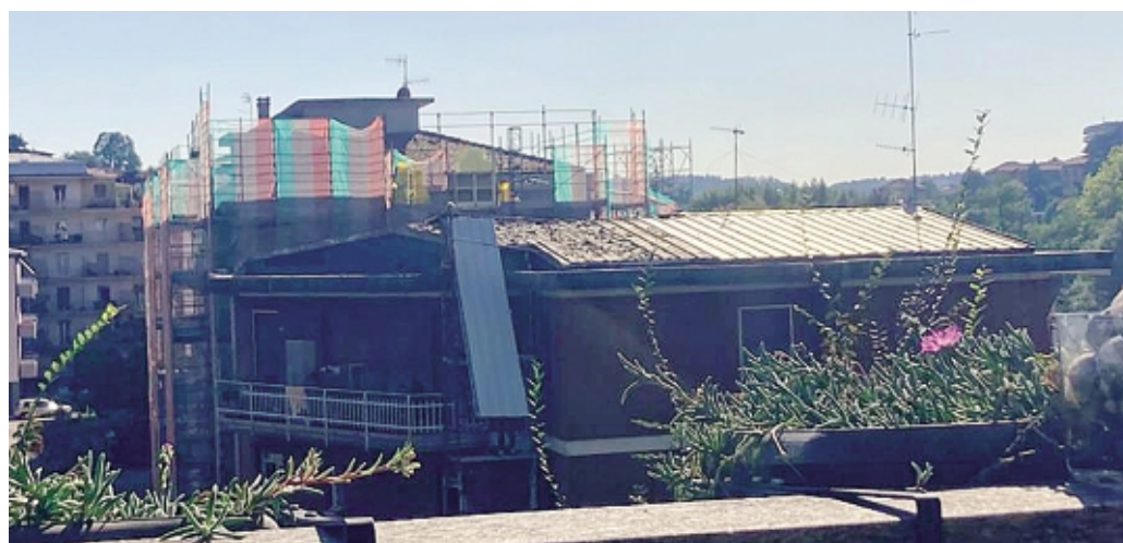
Gli operai impegnati ad issare a mano un lastrone per la copertura del tetto
